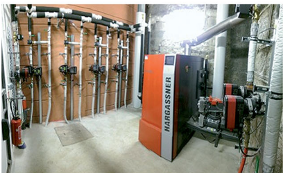
La chaudière consomme environ 50 t/an de plaquettes forestières.
