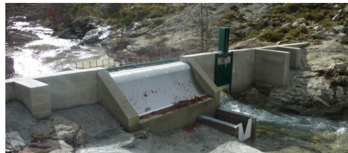
Prise à effet coanda – Centrale de Zicavo
